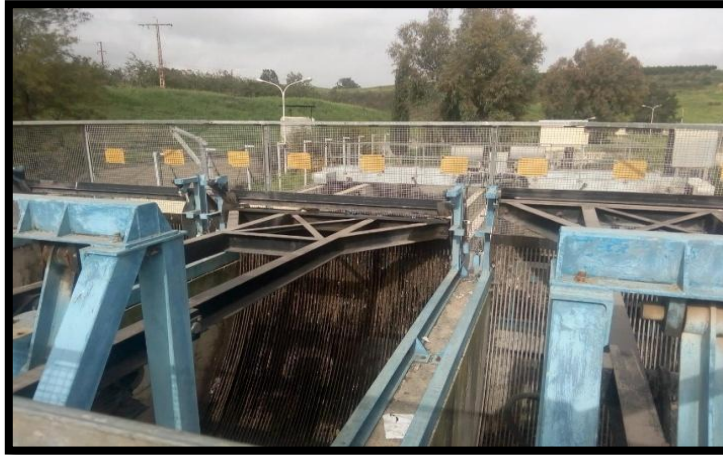
Figure 13 : Dégrilleur de la station d'Iben Ziad.
