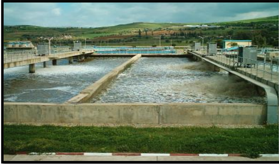
Figure 16 : Bassins d'aération de la station d'Iben Ziad.
