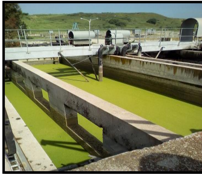
Figure 15 : Vue d'ensemble sur la séparation de la graisse.
