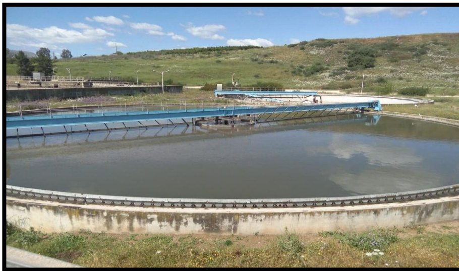
Figure 17 : Décanteurs secondaires de la station d'Iben Ziad.
