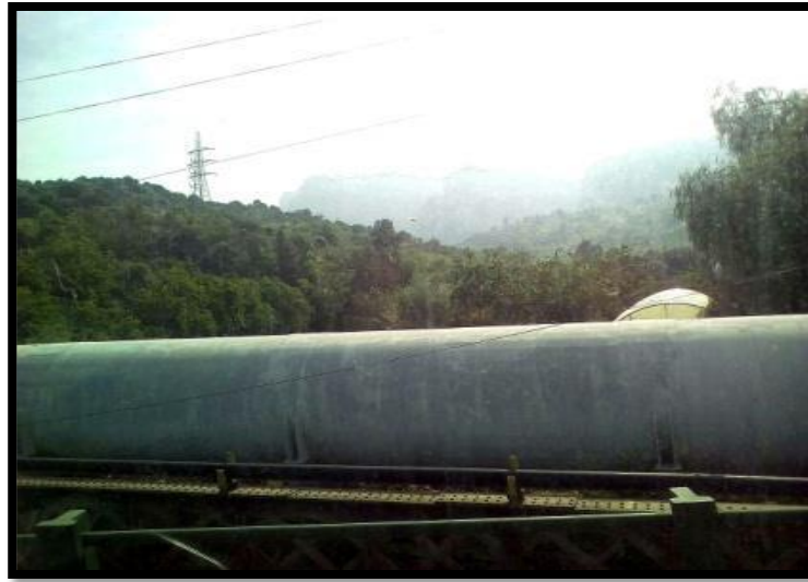
Figure 12 : Conduite principale des eaux usées qui alimentent la station d'épuration d'Ibn Zaid.
