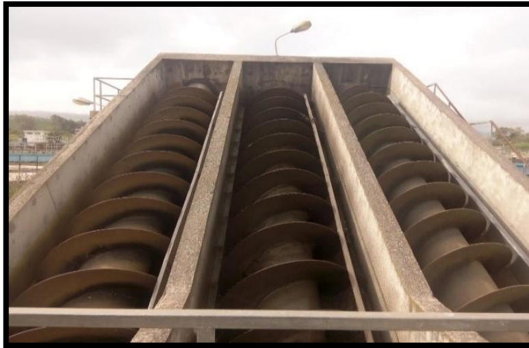
Figure 18 : Vue des trois pompes à vis de la station d'Iben Ziad.
